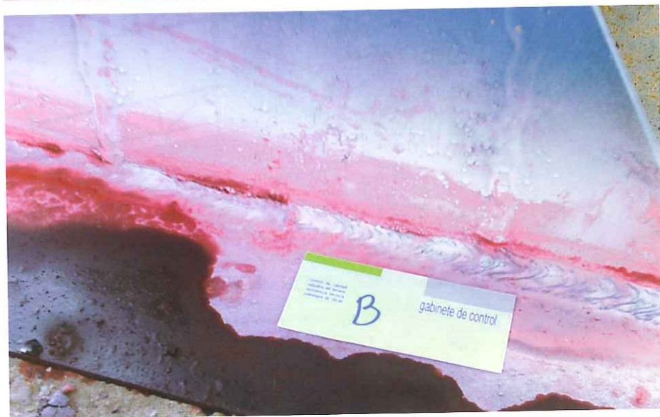
Detalles del proceso de realización del Ensayo de Líquidos Penetrantes, dentro del Plan de Control de Calidad de una Nave industrial. Véanse los defectos detectados en el proceso de inspección y de control, llevados a cabo durante la ejecución de la estructura metálica
